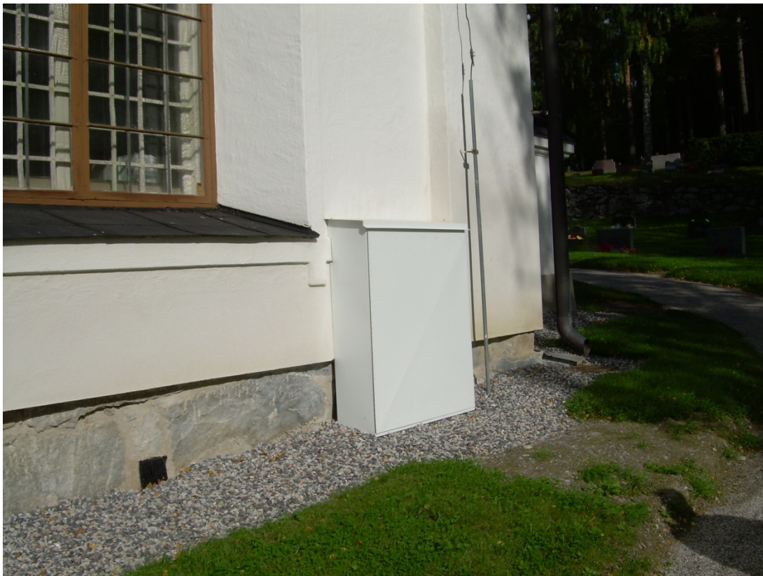
Plåtskåp som döljer rördragningen till bergvärmten.
