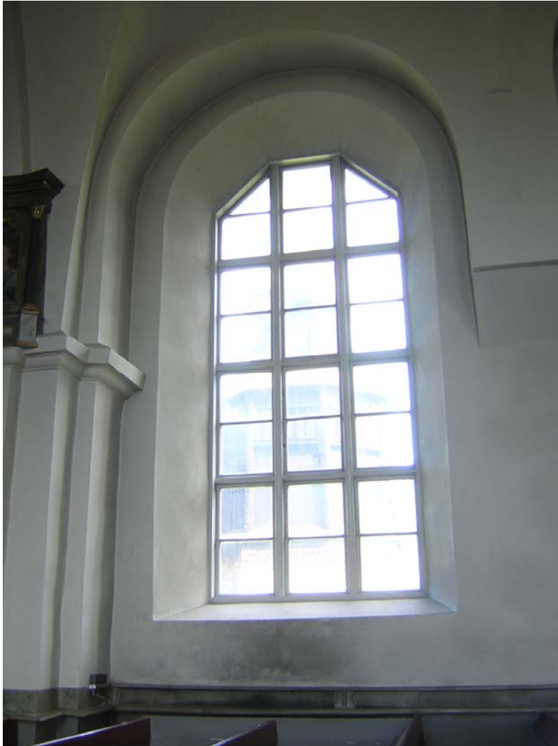
Ej restaurerat fönster mot norr. 2006-06-30
