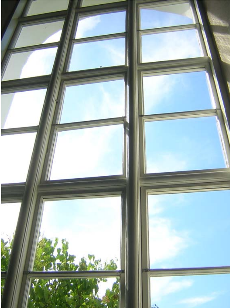
2006-07-03. Ommålat innanfönster södra långväggen.
