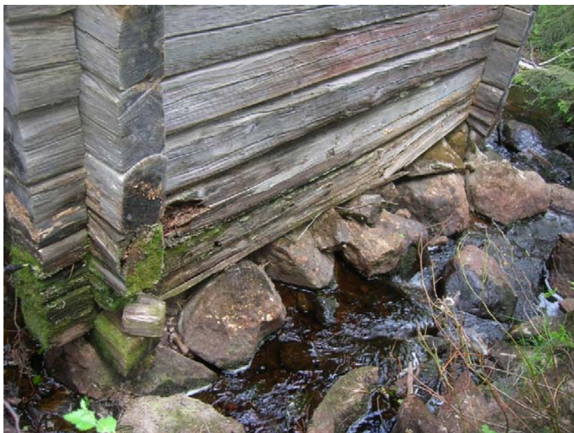
2011-06-14. Baksidan (östra gavelväggen) med avbruten syllstock och knutskalle samt kraftiga rötskador även på andra varvet.
