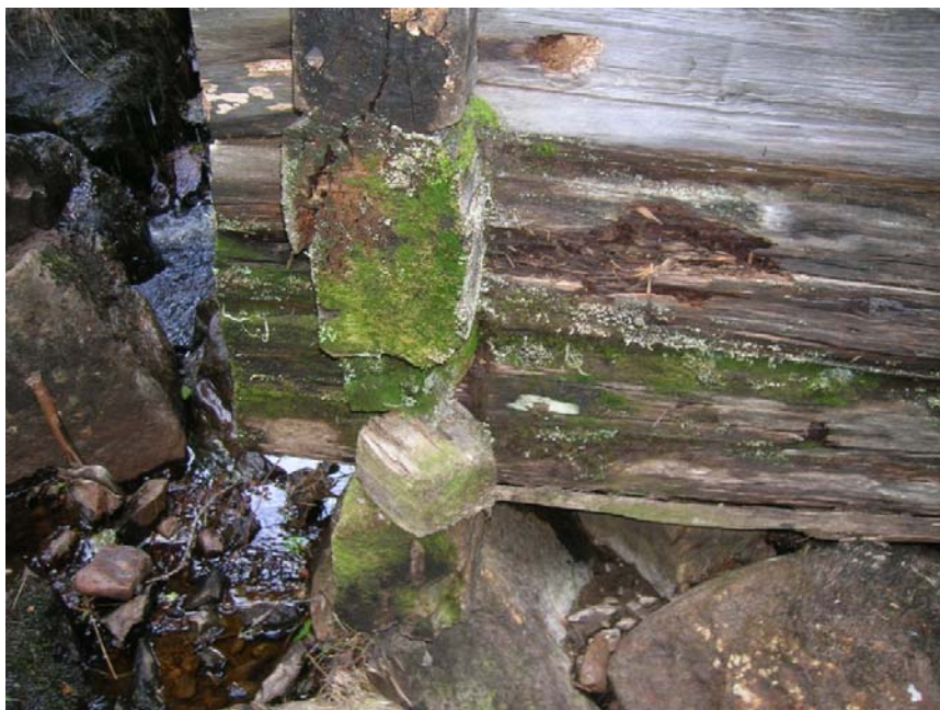
2011-06-14. Rötskador på SO knuten.
