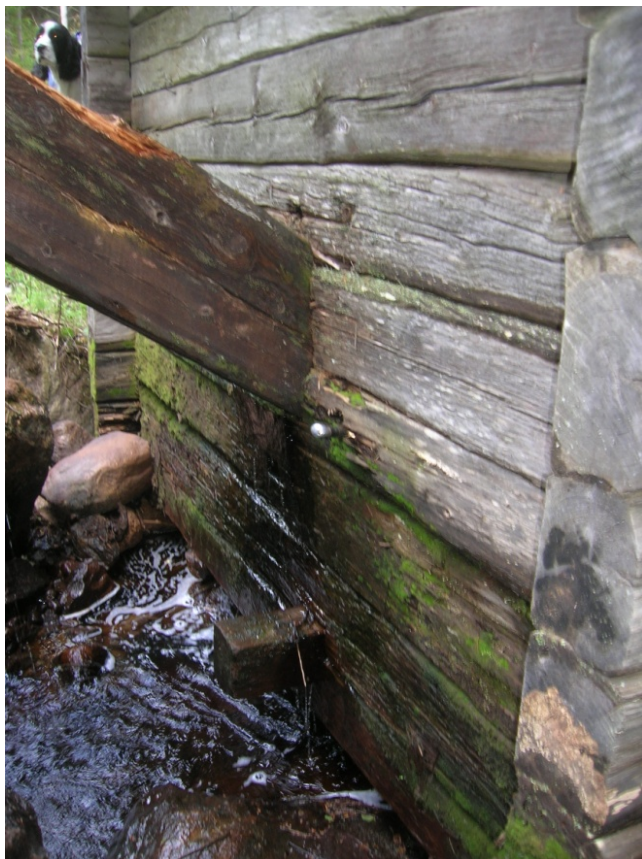
2011-06-14. Rötskador på syllstock och ovanför liggande timmer på södra väggen vid intaget.
