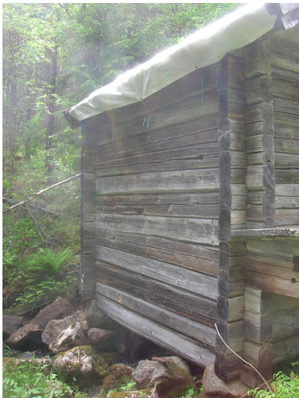
2011-06-14. Norra väggen ner mot sluttningen. Av myrgångarna inuti syllen syns inget.
