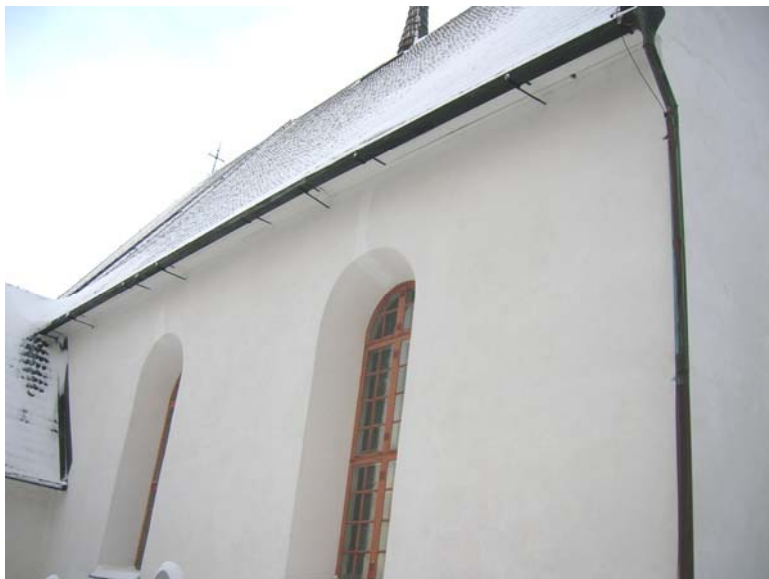
Spricklagningar ovanför fönstren på norra fasaden.
