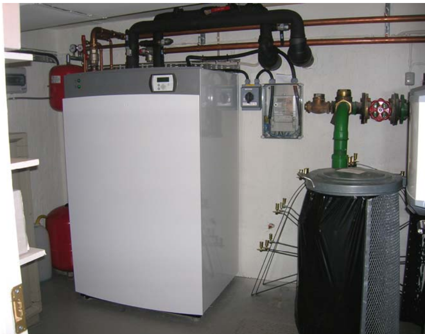
Värmepumpen i pannrummet.
