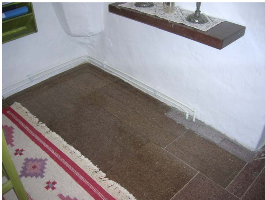
Rören går nerifrån pannrummet upp till sakristian.
