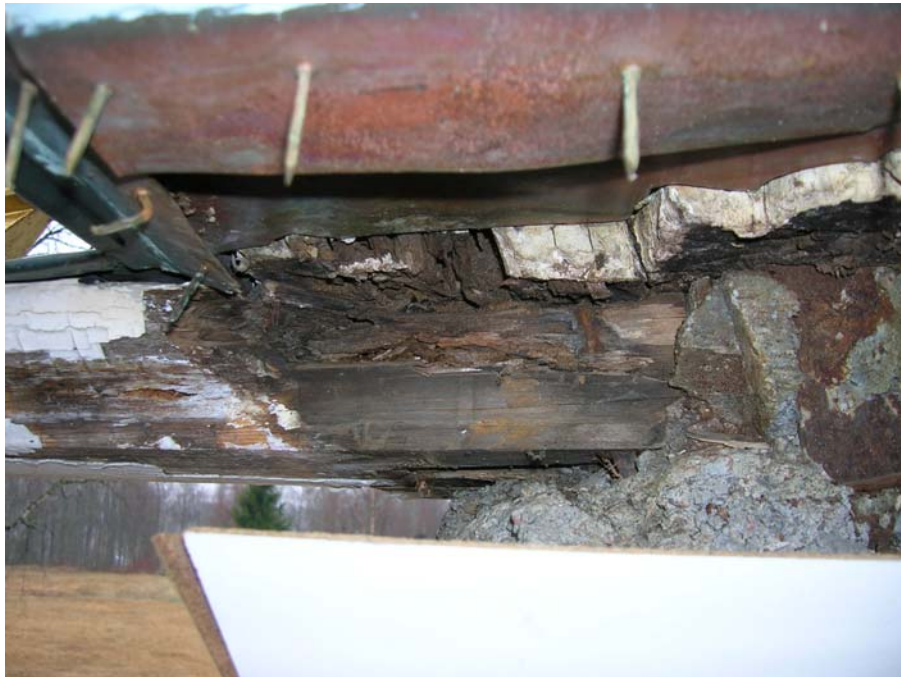
Rötskadad ände av överliggaren fäst vid utbytt kapitäl. 2005 05 03.
