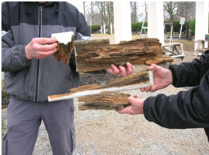
Rötskadat trä i norra bågen. 2005 05 03.
