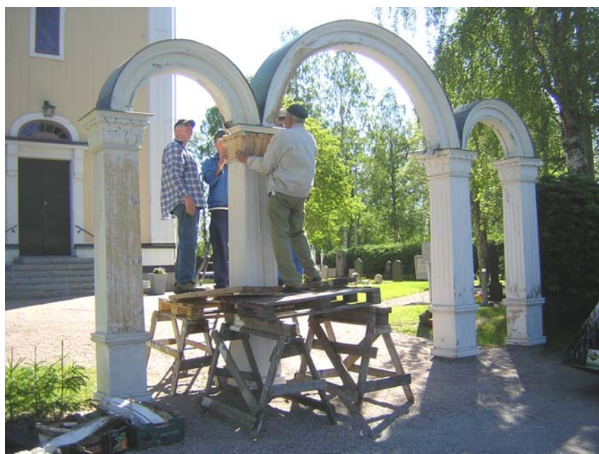
Kapitålet håller på att fästas i en av de två kolonnerna som bär den centrala bågen 2006 06 29.
