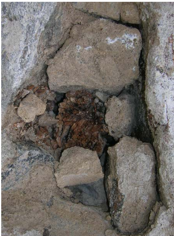
Ände av rötskadad träbjälke, ev. rest efter bomlag i murverket (se skissbilaga).
