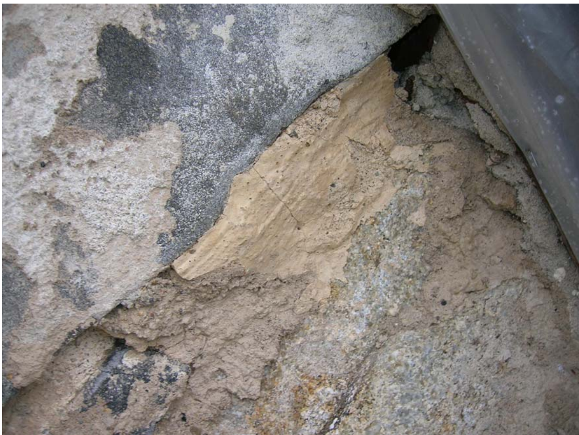
Äldre putsrest vid norra takfallet nära NO hörnet mot sakristian.
