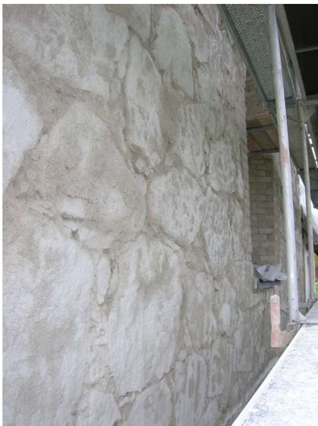
20070521. Grundad fasadyta som stått 4 dagar och börjat vitna nertill på östra fasaden.
