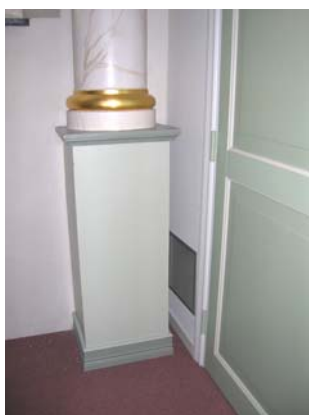
Ventil bakom pelaren i vägg mot "lillkyrkan" där rör har installerats. 2005 05 26.
