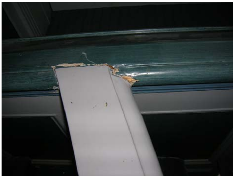
2010-06-07. Färgskada på överliggare, återmonterad altarring södra sidan. Bättrad senare.
