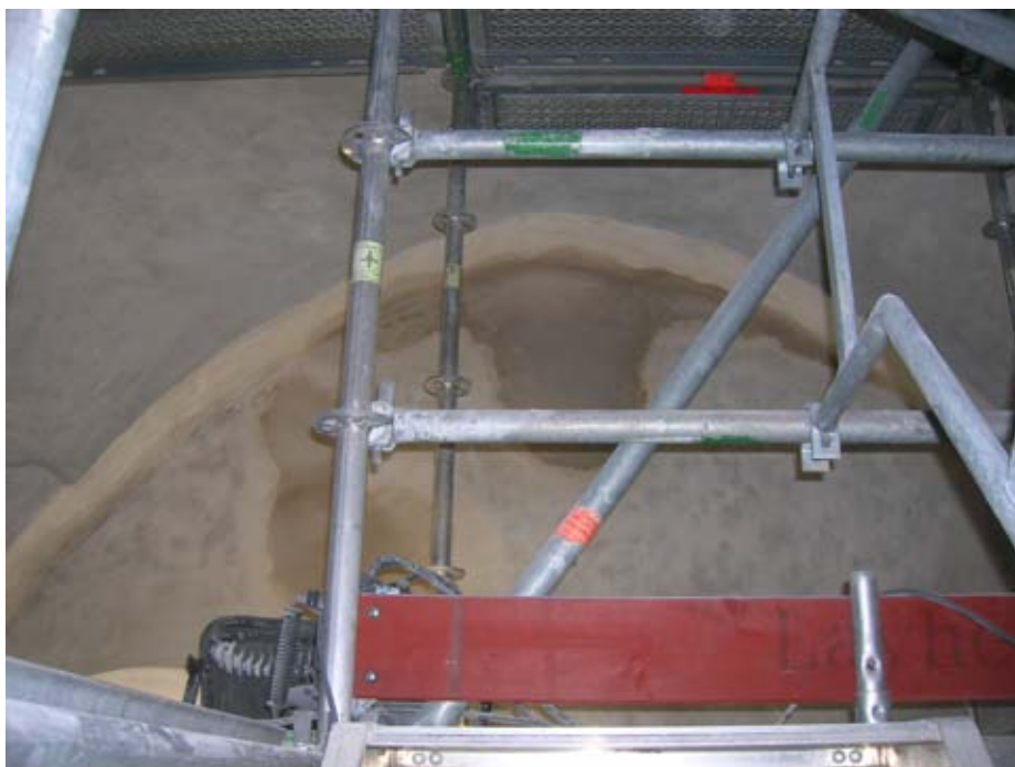
2010 09 20. Putslagningar ovanför södra porten med synlig karbonatisering.
