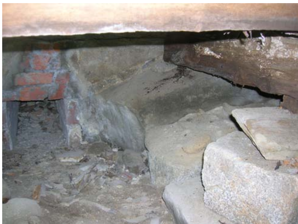
2010-04-21. Svampskadad bärlina framme vid korväggen på norra sidan.
