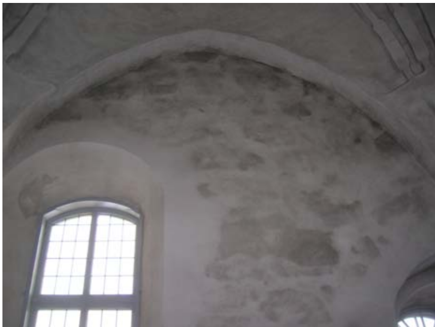
2010-04-06. Smuts, spricka södra långhusväggen (kyrkportens överljus till höger).
