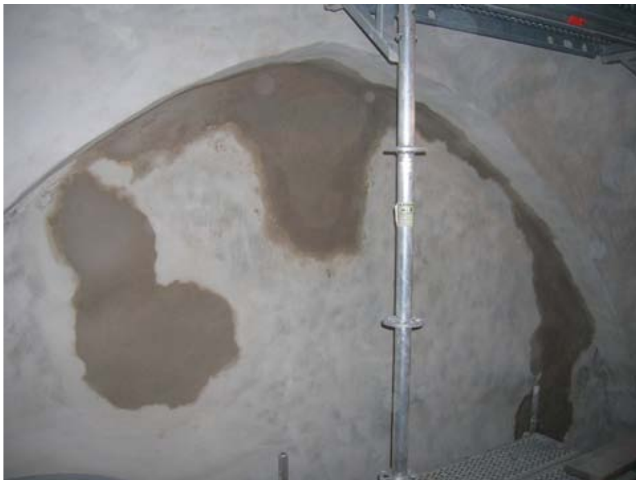
2010 09 16. Putslagningar i valvbåge med djupa skador ovanför södra porten, där stenar hade fallit ner.
