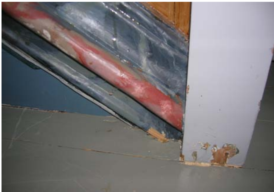
2010-06-07. Färg- och träskada på rundlist på predikstolens återmonterade vangstycke mot golvet. Skada på stolpen fanns sedan tidigare.
