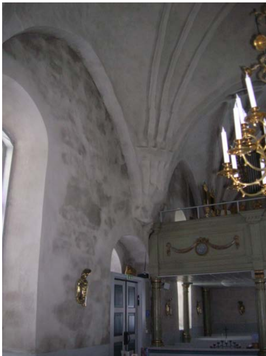
2010-04-06. Sprickor och smuts södra långhusväggen före lagning/ avfärgning.
