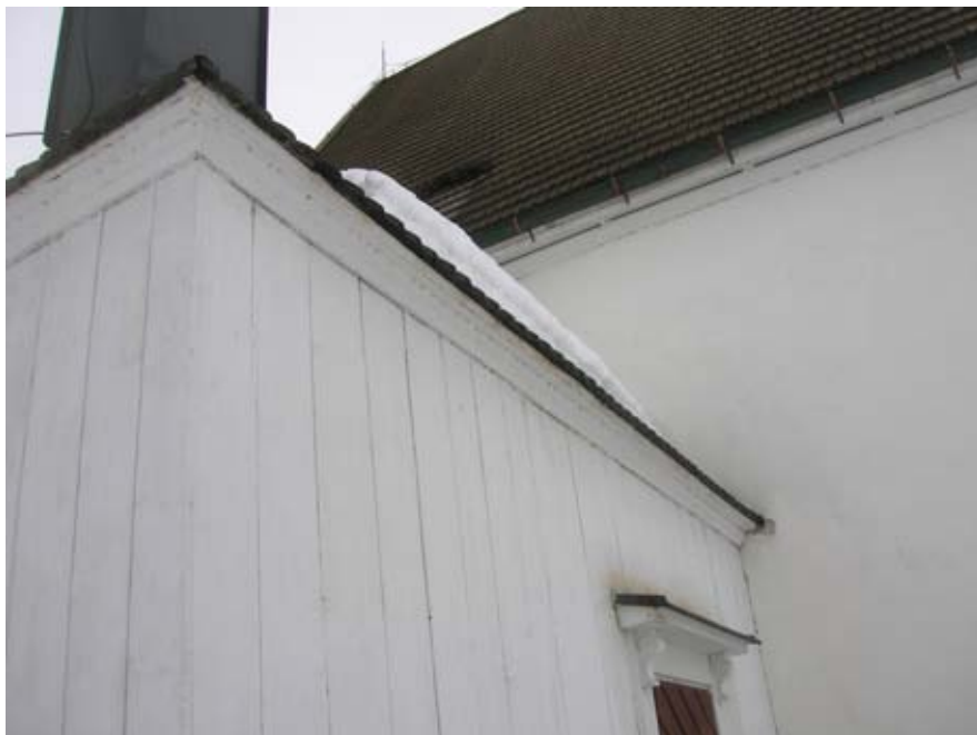
2010-03-10. Nerrinnande vatten utmed sakristians tak orsakar putsskador på kyrkväggen.
