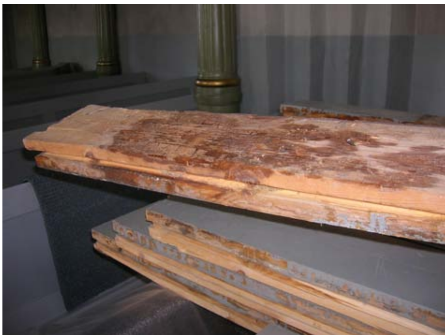
2010-04-21. Rötskador på golvbräda.
