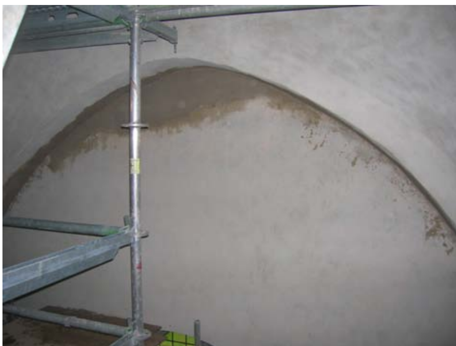
2010 09 16. Spricklagning på norra väggen ovanför fönster.
