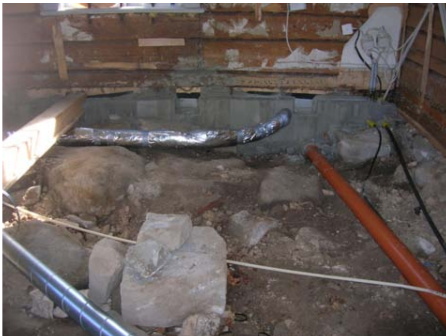
2010-06-07. Dräneringsröret till östra grundmuren samt avfuktningssaggregatets rör.
