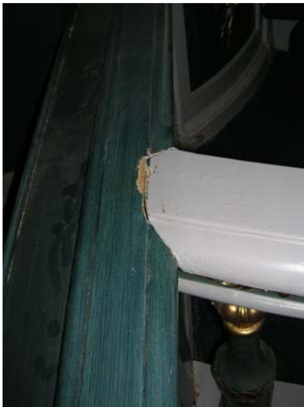
2010-06-07. Färgskada på överliggare, återmonterad altarring norra sidan. Bättrad senare.
