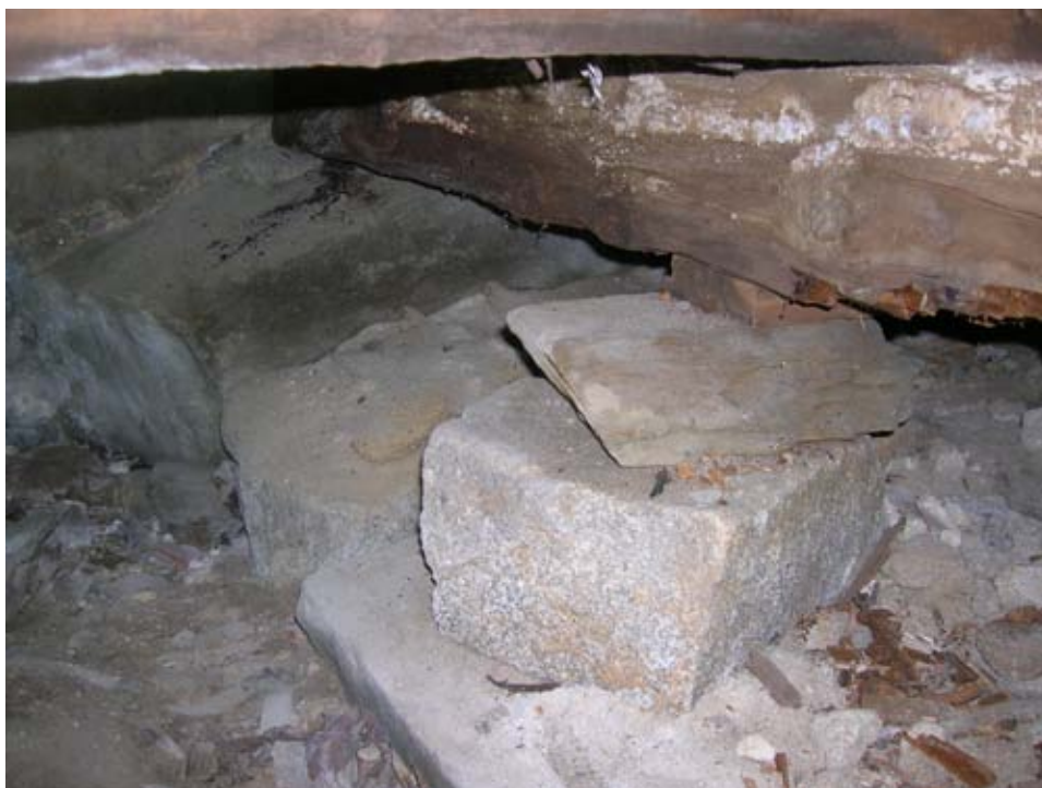
2010-04-21. Grundstenar ca 0,5-1 m från korväggen under 2:a bärlinan (två hopsatta sönderfräta plankor) från norra väggen med svampskador.
