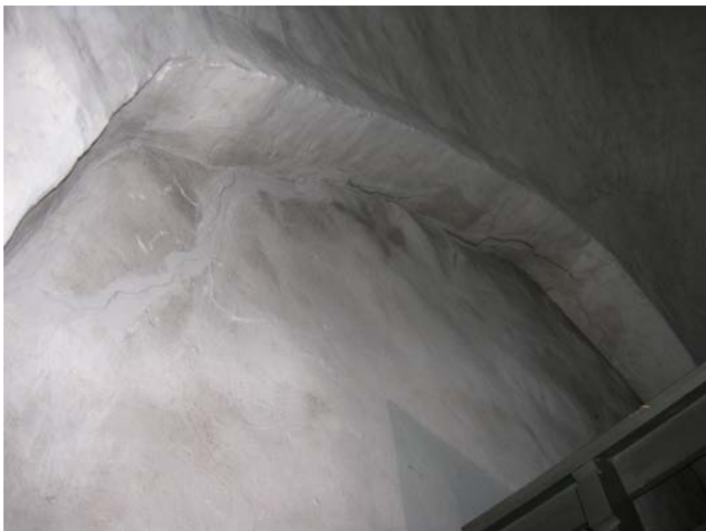
2010-04-06. Sprickor, norra väggen ovanför läktartrappan.
