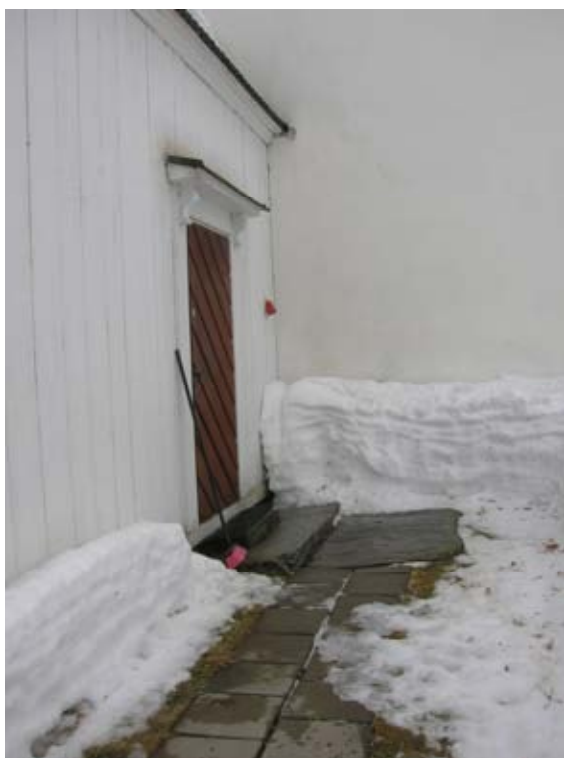
2010-03-10. Vatten rinnner in under grunden, där marken lutar kraftigt mot sakristians västra sida.
