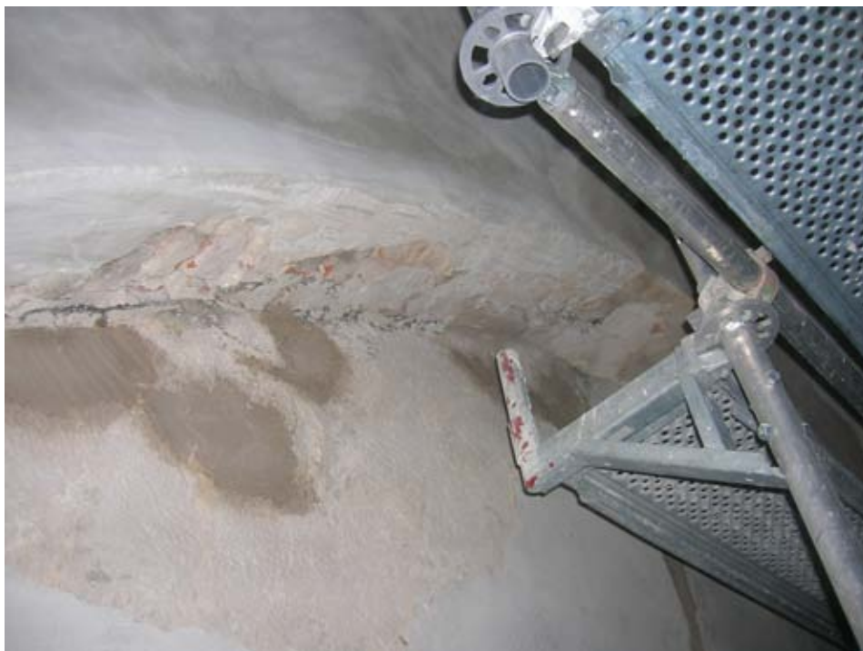
2010 09 16. Detalj, spricklagningar i valvbåge, norra läktarväggen.
