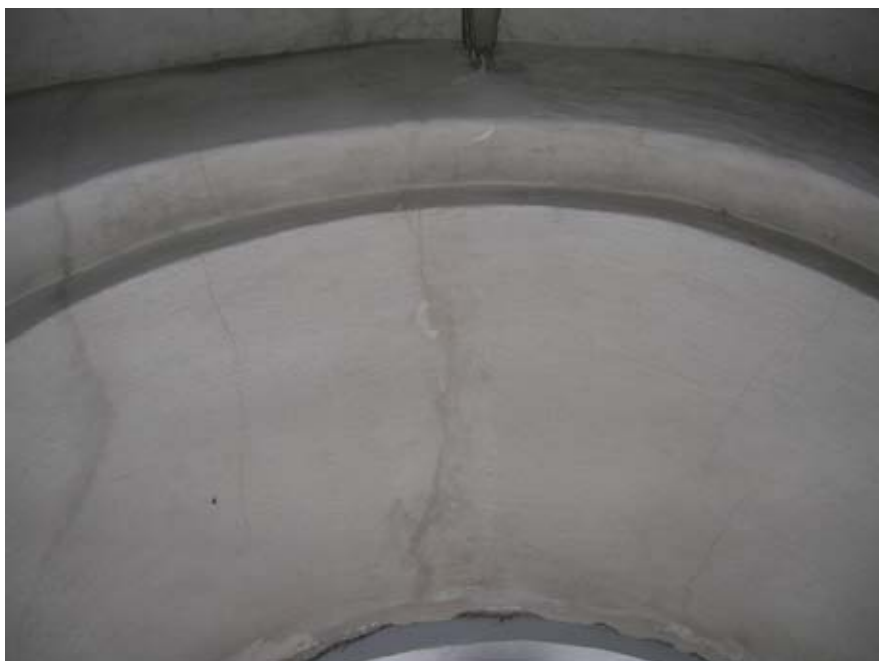
2010-04-06. Tunn spricka ovanför fönstervalv, västra fönstret.
