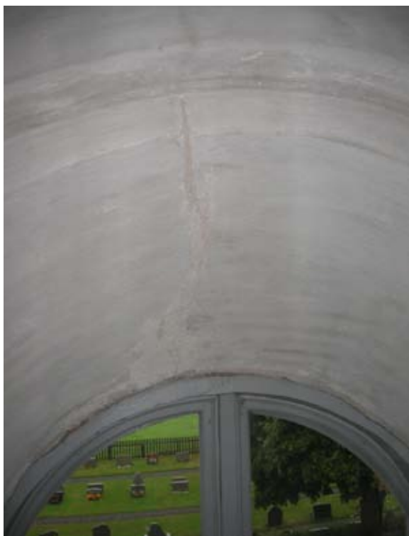
2010 09 16. Putslagad tunn spricka i västra fönstervalvet.
