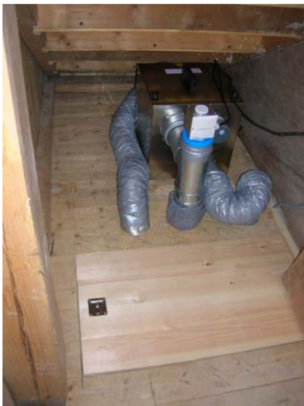
2010-06-07. Avfuktningssaggregat installerat i en skrubben under norra läktartrappan.
