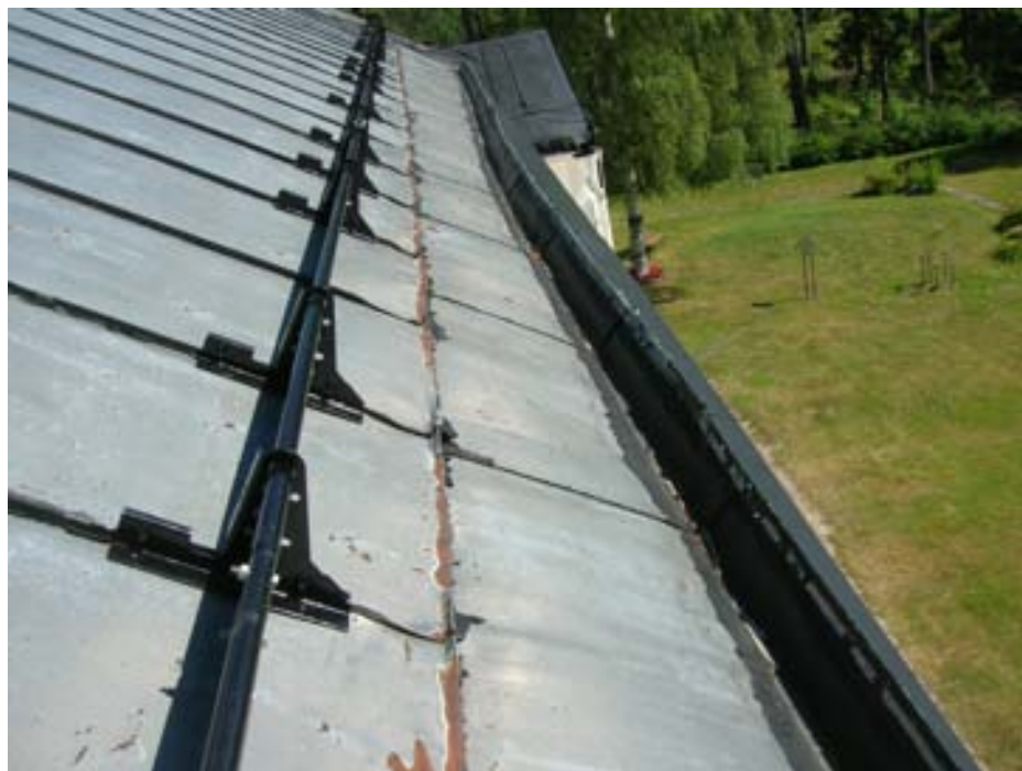
2010-07-15. Södra takfallets bandplåt före blästring.
