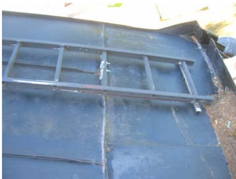
2010-07-15. Takstege före rostbehandling/om målning.
