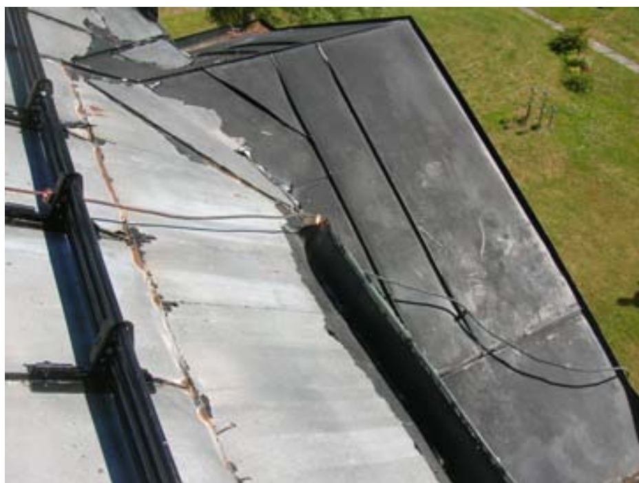
2010-07-15. Södra takfallets bandplåt före blästring.
